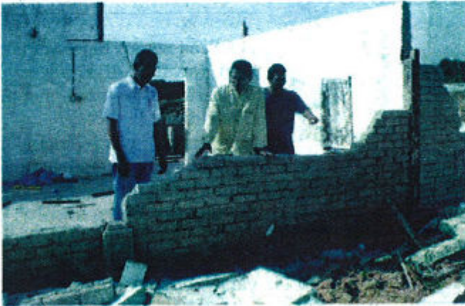
● Ismail (kiri) dan dua penduduk kampung melihat kesan rumahnya selepas kerja-kerja perobohan selesai untuk memberi laluan kepada pembinaan landasan keretapi berkembar di Kampung Permatang Saga.
